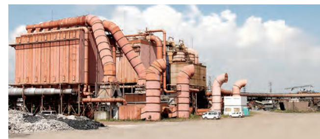
●集塵装置(筑波工場)
