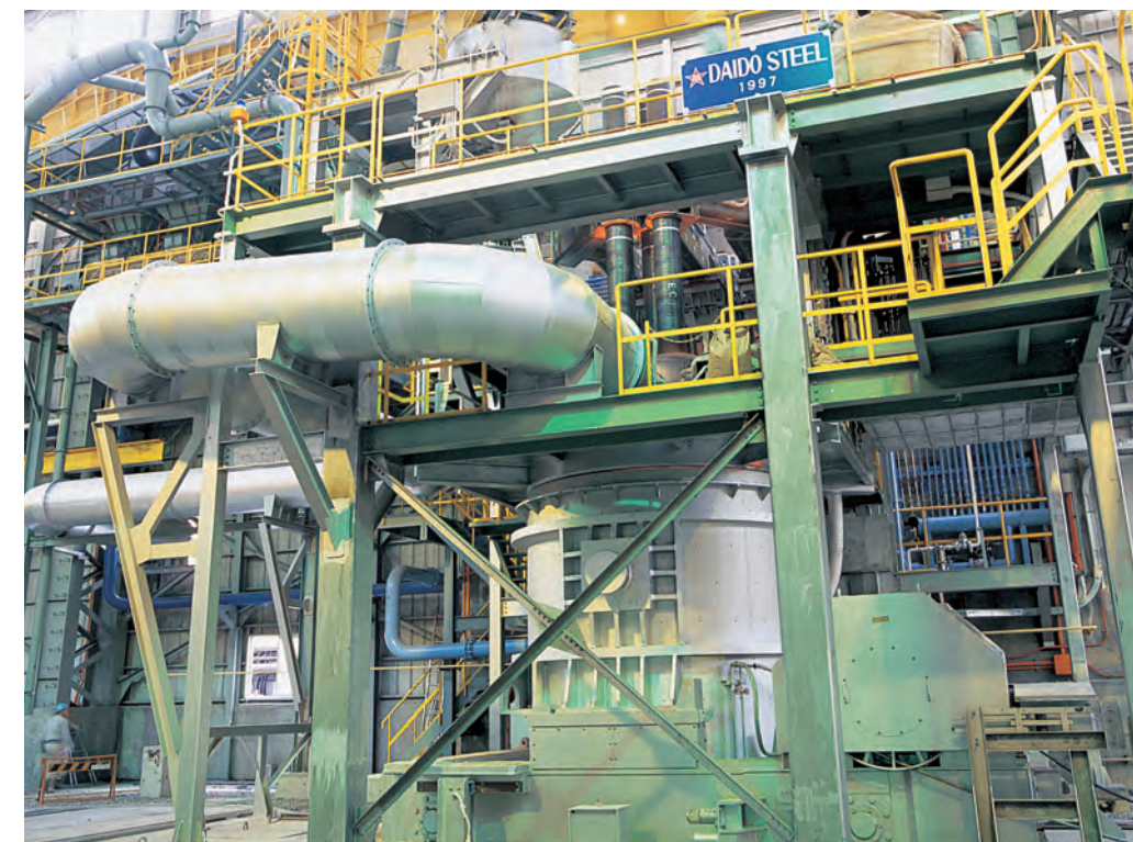
●LF 精錬専用設備(石巻工場)
